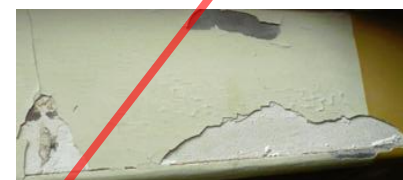
Plâtre contenant peinture au plomb
