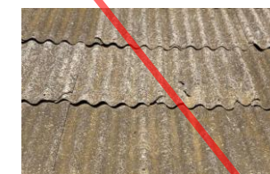
Produit amianté : isolant, fibrociment
