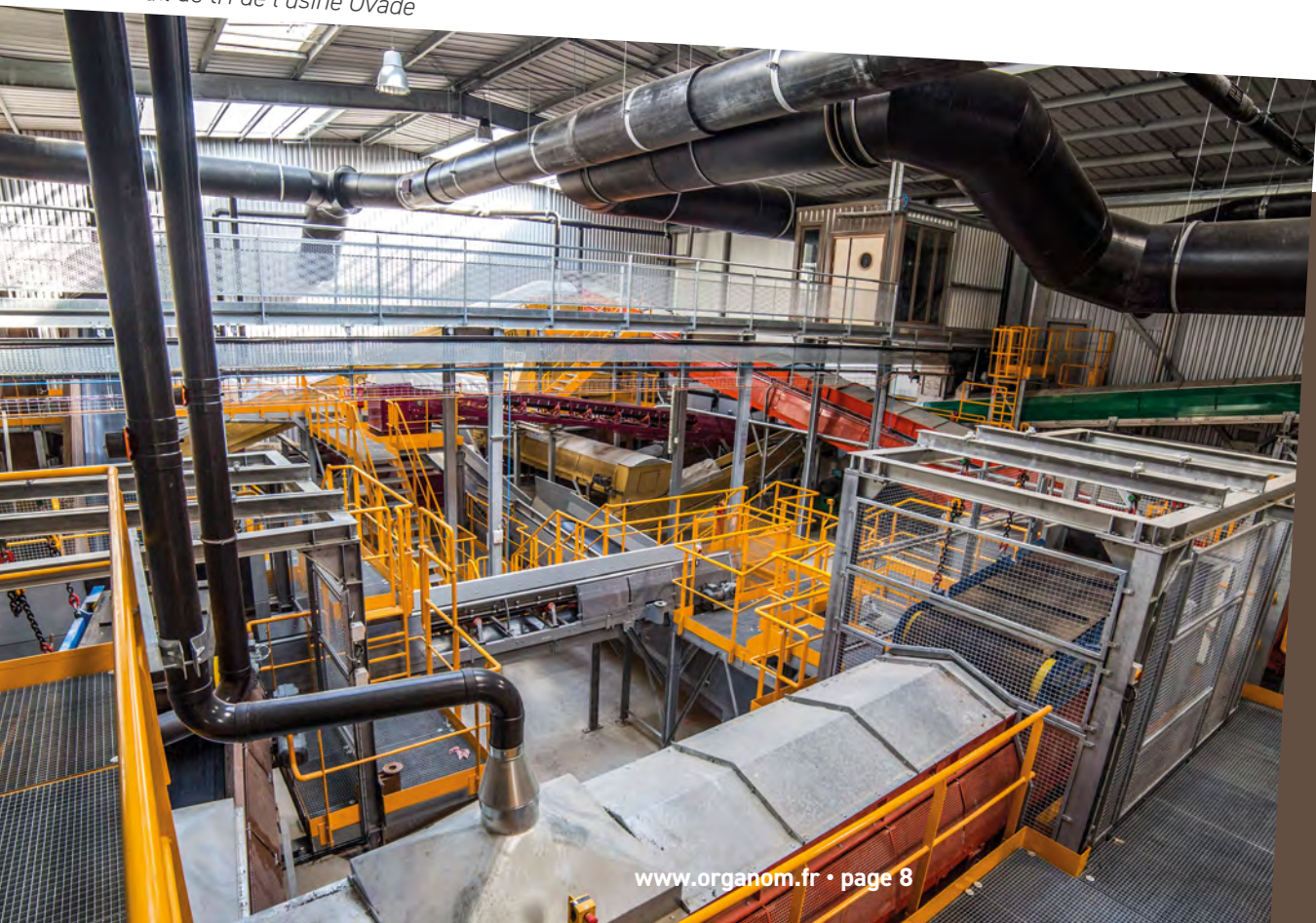
Le hall de tri de l'usine Ovade
