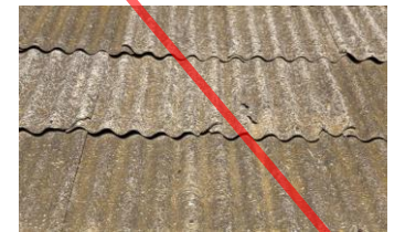
Produit amianté : isolant, fibrociment
