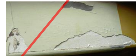
Plâtre contenant peinture au plomb
